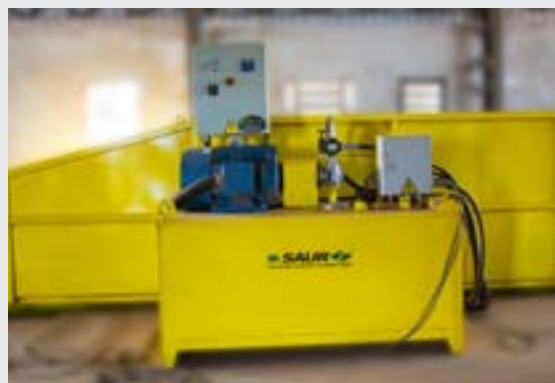
Undidade Hidráulica da Plataforma de Descarga
